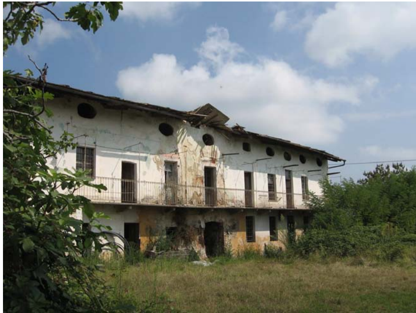
L'abbandono dei cascinali storici
